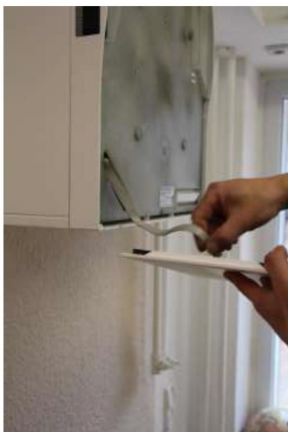
Einbau des Ne xt im Aufenthaltsraum ©LUNOS
